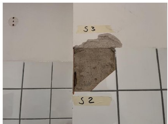
Abbildung 31: PN – Stellen S2, S3, Fugenmasse, Spachtelmasse.
