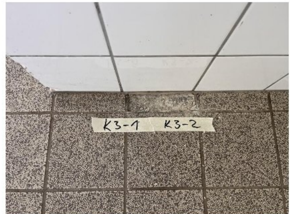
Abbildung 38: PN – Stellen K 3-1, K 3-2, Fugenmasse Fliesen, Kleber.
