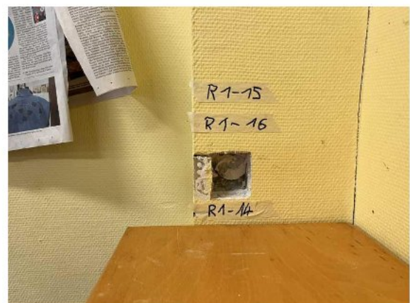
Abbildung 11: PN – Stellen R 1-14, R 1-15, R 1-16, Spachtelmasse, Spachtelmasse, Spachtelmasse.
